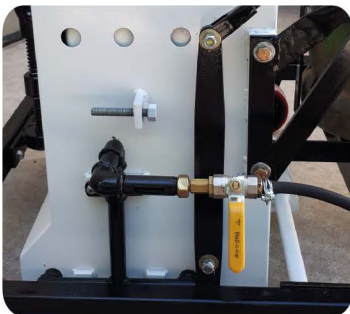
Conexión de gas
